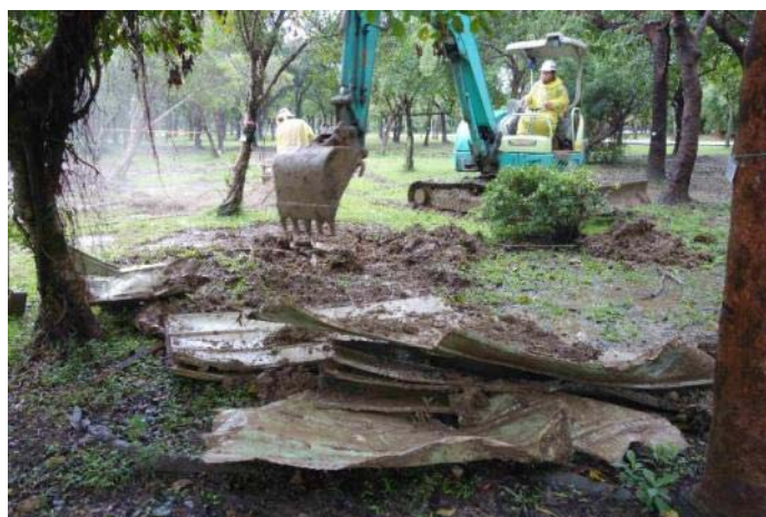
照片 2-8 No.15 榕樹區土表處理有建築工地用圍籬鐵板
