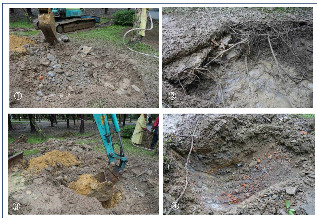
照片 5-14 榕樹區中的劣質土壤
