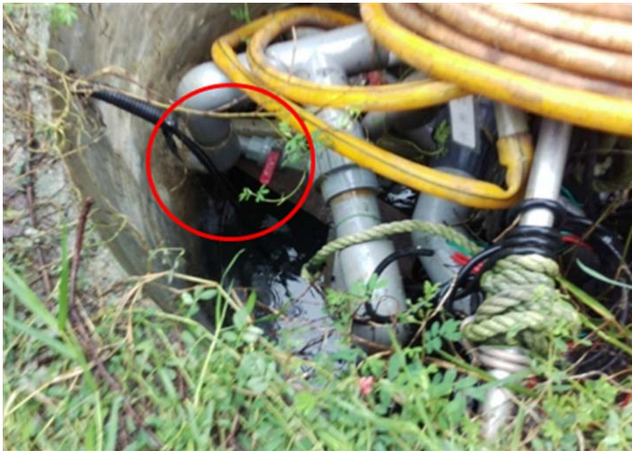
圖3-3 集水井水位計
