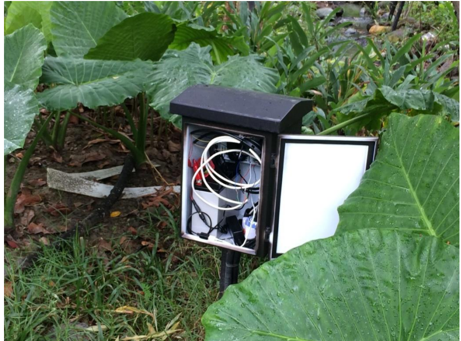
圖2-6 控制箱設置位置
