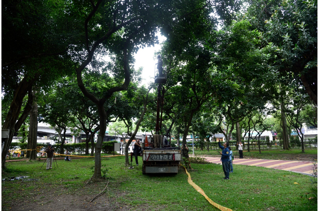
圖 1.架設巢位監測系統線路
